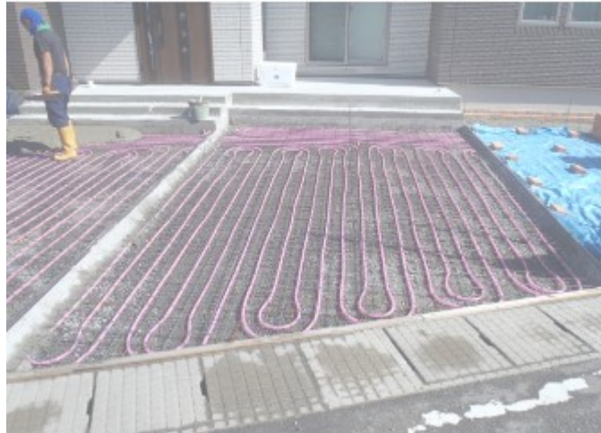
融雪システムのパイピング写真
