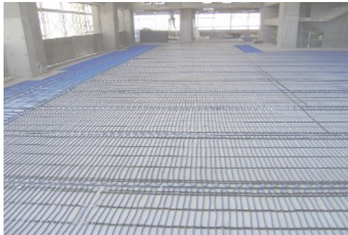
床暖システムのパイピング写真
