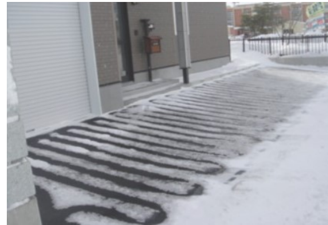
融雪システムの稼働状況写真
